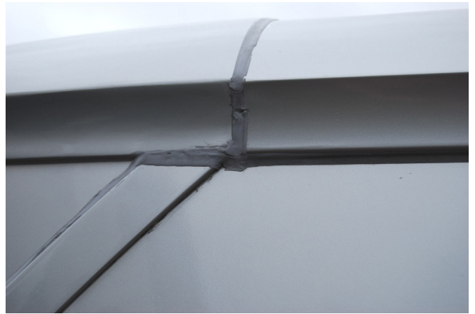
Abgelöste Dachhaube, wurde einfach verkittet, Beispiele wie man es nicht machen sollte.
