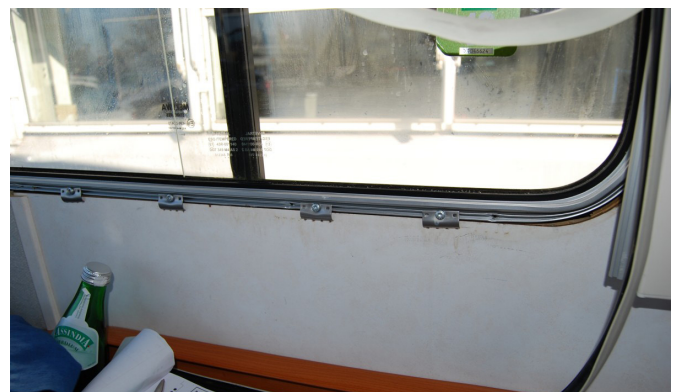
LMC, Wassereintritt, falsch montierter Fensterrahmen
