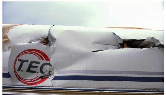
TEC, aufgerissenes Dach, Car-Port-Dach, vergessen.
