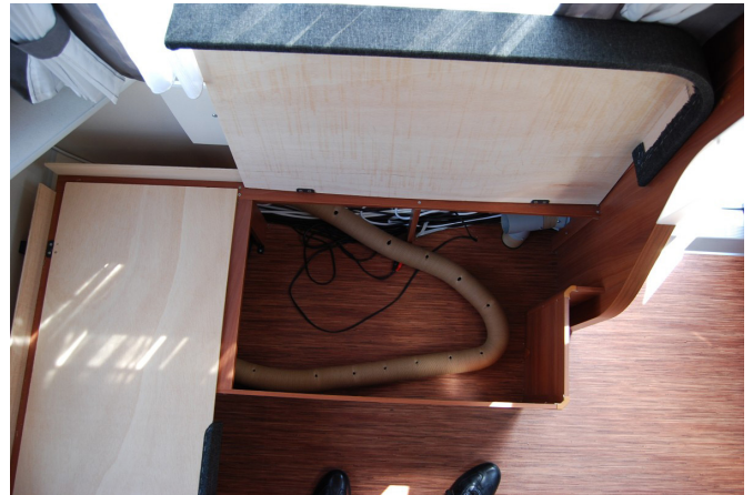
Pfusch-„Reparatur“ im Hobby Wohnwagen. Feuchte-Ausstockung durch anbohren der Fahrzeugheizung!
